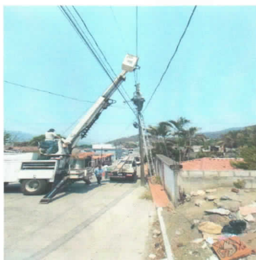
El Porvenir 2 (verificación de Transformador)
